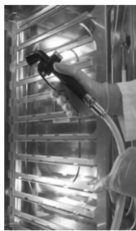
Rinçage de l'enceinte de cuisson
